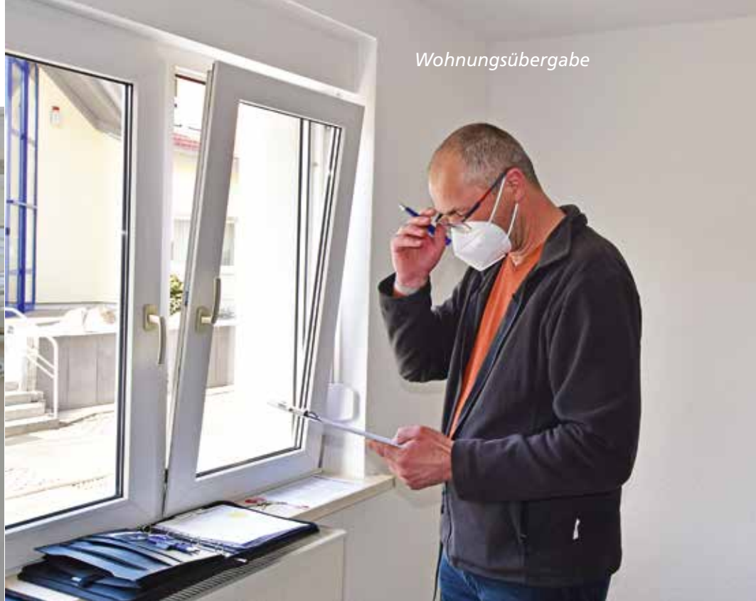
Erstbegehung und Bestandsaufnahme: Hier wird die Sanierung der Zimmerdecken notwendig sein.
